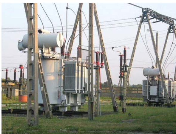
Rys. 2.15. Transformator sieciowy olejowy.
